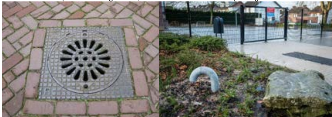
Figur 16: Udluftningen kan ske via. Et særskilt dæksel med åbent dæksel (se foto tv.), svanehals eller som tilslutning i en rendestensbrønd (se foto th).
