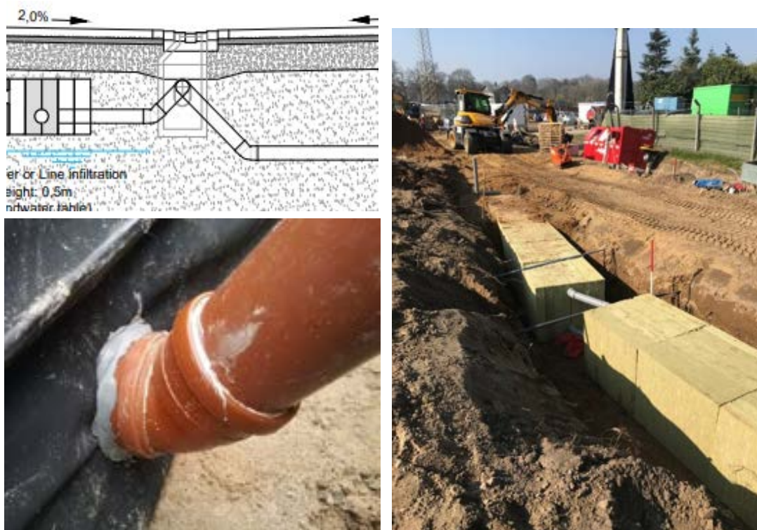
Figur 6: På skitsetegningen (øverst tv), ses eksempel på rørføring med max 45^\circ bøjninger mellem Rockflow anlæg og brønd. Eksempel herpå ses også på fotos nederst tv og th.
