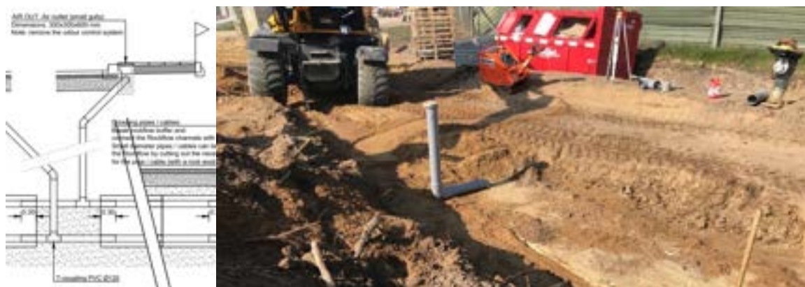
Figur 15: Udluftning af Rockflow anlæg. Udluftningsrør fra anlægget føres til terræn.
