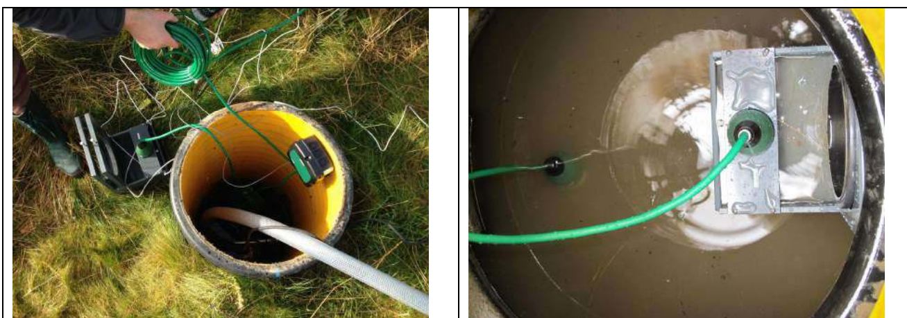
Figur 12. Venstre: på jorden ved siden af brønden ses den specialdesignede ”opsamlingskasse”, hvor der også er placeret en tryktransmitter. Øverst i brønden ses Chatteren som logger og transmitterer data via et simkort og en antenne monteret uden på brønden. Højre: Et kig ned i brønden hvor man i venstre side kan se tryktransmitteren ved brøndens bund og i højre side kan se opsamlingskassen med tryktransmitter monteret på det øvre drænrør.
