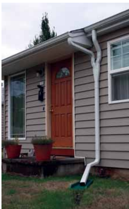
Afkobling af tagvand, Portland.
