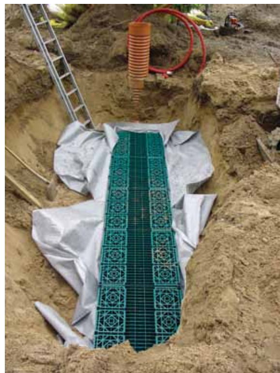
Nedgravet rendefaskine Foto: Nyrup Plast faskine
