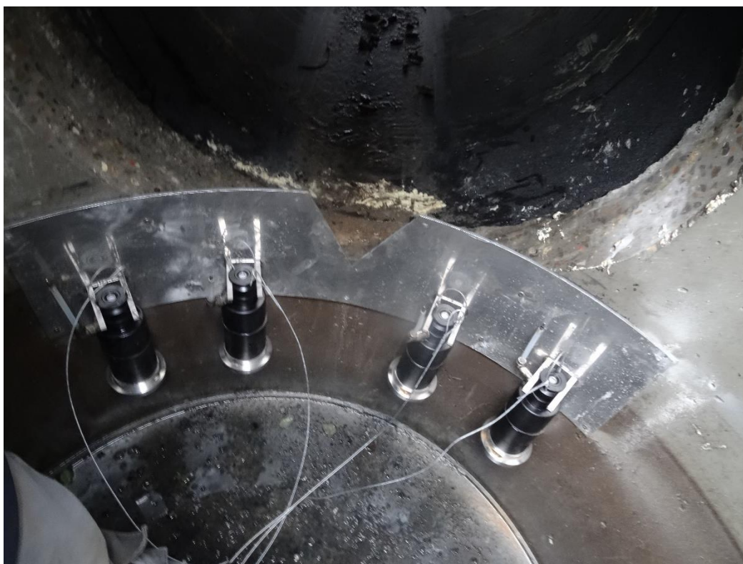
Figur 3-5: Placering af WW50 (holder til SorbiCell) på udløbssiden i regnvandsbrønd. Når vandet i forbindelse med nedbør stiger op i brønden, vil regnvandet blive presset igennem SorbiCellerne, som sidder i WW50'erne. Opsætningen på billedet indeholder fire forskellige typer af SorbiCeller til monitoring af henholdsvis næringssalte, tungmetaller, PAH og phthalater.
